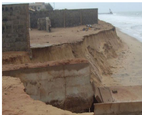
Рис. 7. Июль 2013, отель, расположенный недалеко от пляжа полностью разрушен морем July 2013, the hotel, located near the beach completely destroyed by the sea
