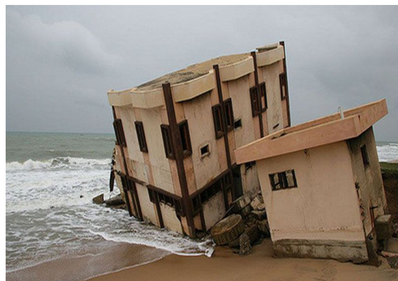
Рис.6. Август 2017, здание расположенное недалеко от пляжа разрушенное абразией August 2017, a building located near the beach destroyed by abrasion
